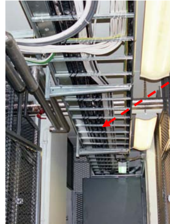
Kabelstege i källare
